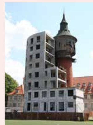
Ilustracja 26. Przekomponowane bezpośrednie otoczenie zabytkowej wieży ciśniowej w Szczytnie. Kontrowersyjna inwestycja niemal całkowicie zasłoniła zabytek i niekorzystnie wpłynęła na panoramę tej części miasta, fot. P. Kobek, archiwum NID
